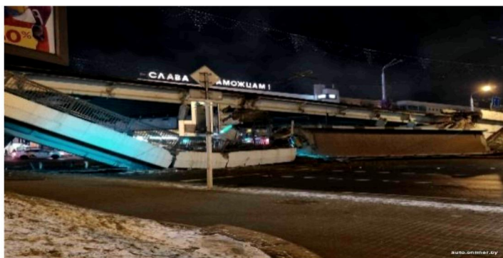
Рисунок 2 – Обвал пролета моста в г. Минске
